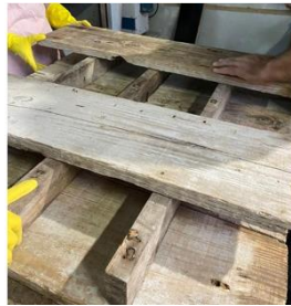
Figura 7: Construção do protótipo da parede de tabique. Fonte: Acervo pessoal das autoras.
